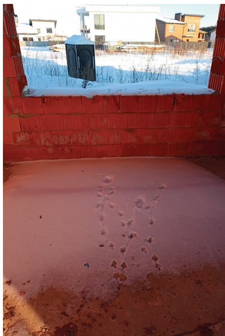
Следы куропаток в недостроенном доме, 23.02.2023 г.
